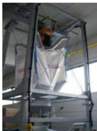
Станция загрузки песка в рабочий контейнер
